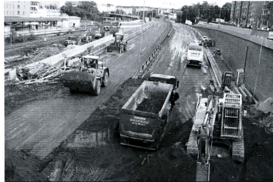
Abbaggern und Abtransport der Erde, die zum Schutz der Fahrbahn vor Trümmerteilen aufgebracht wurde.
